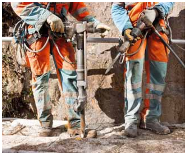
Foto 8 Non impiegare apparecchi troppo potenti. Esempio: evitare di usare un martello demolitore per lavori di scalpellatura semplici.
