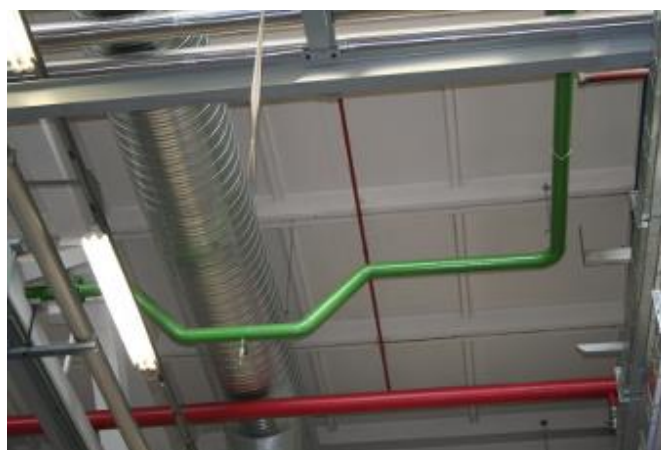
Figura 3: Interazione tra diversi impianti e tra struttura e impianti. Tubazione rossa: impianto antincendio; tubazione verde: acqua industriale; tubazione grigia: acqua surriscaldata.
