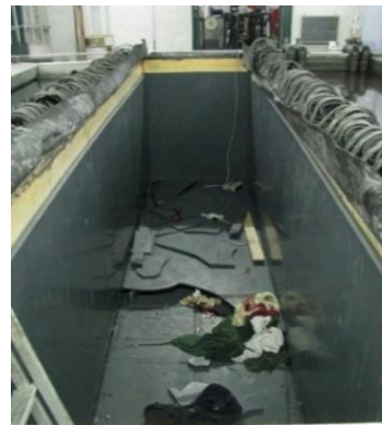
Foto 2: vasca in manutenzione dopo l'esplosione
