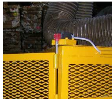
Dettaglio microinterruttore di sicurezza idoneo
