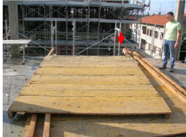
Pannello (già staccato e adagiato a terra) che stava staccando il lavoratore, la freccia indica la zona dove stava lavorando al momento dell'infortunio
