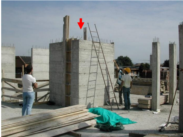
parete esterna vano ascensore, la freccia indica la posizione dell'infortunato al momento della caduta
