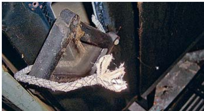
Cordone di amianto usato come guarnizione su un impianto
