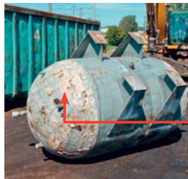
Isolamento contenente amianto su una cisterna d'acqua
