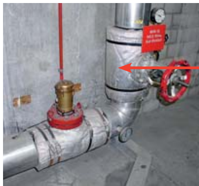
Rivestimenti di amianto termoisolanti
