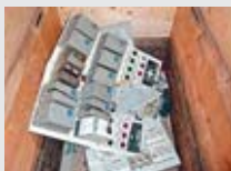
Apparecchi e quadri elettrici
