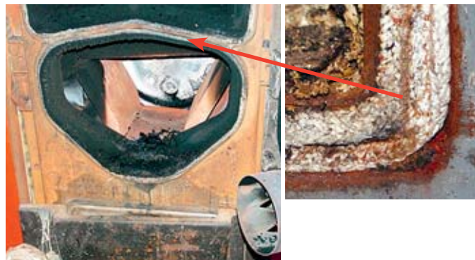
Cordone di amianto su una caldaia
