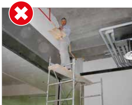
Piano di calpestio incompleto e assenza parapetti
