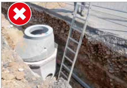
Assenza di protezioni
