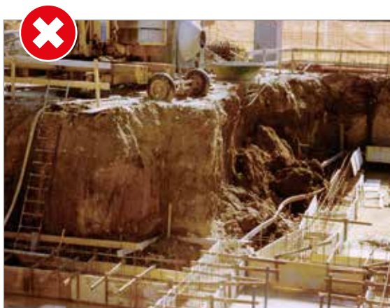
Parete di scavo con inclinazione errata ed evidente franamento
