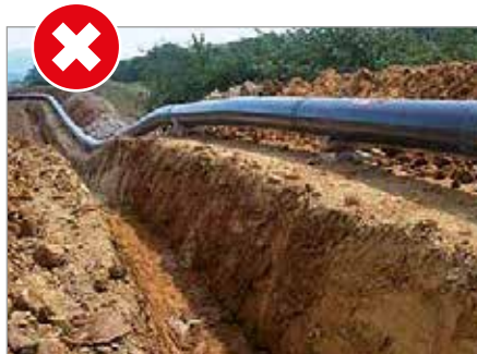
Assenza di protezioni
