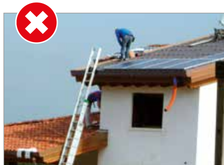
Scala non fissata. Assenza di protezione in quota
