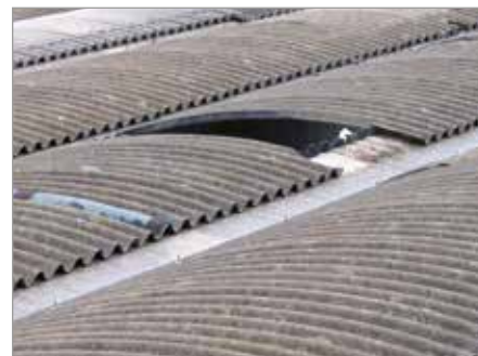
Sfondamento copertura non portante in laterizio
