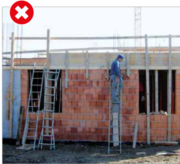
Scala non fissata o trattenuta. Presa non sicura
