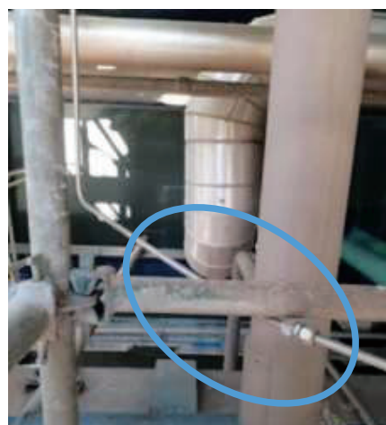
Figura 1 Interferenza per errato posizionamento del ponteggio - deformazione tubo strumentazione (cortesia Iplom)
