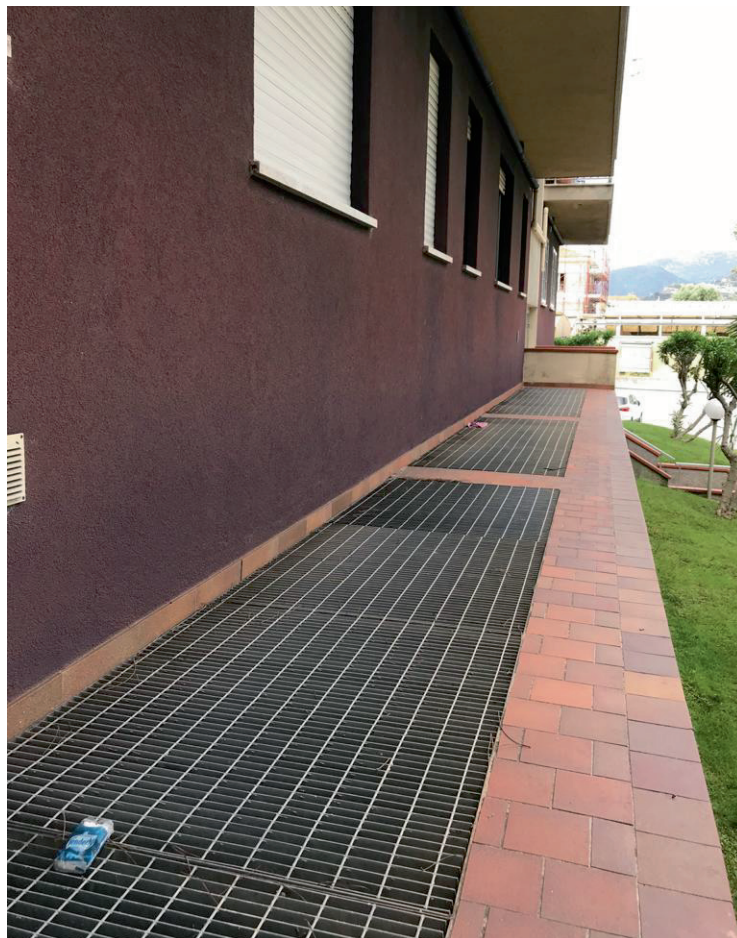
GRIGLIE DI AERAZIONE DELL'AUTORIMESSA
