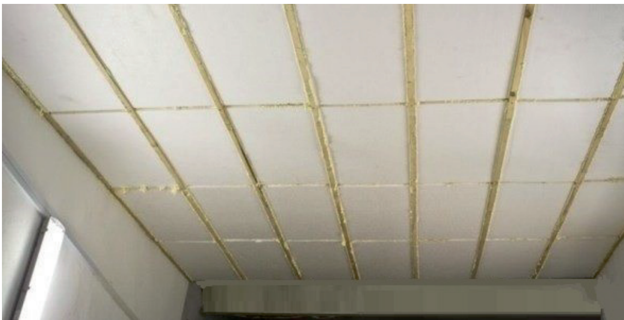
PANNELLI DI MATERIALE ISOLANTE DI TIPO NON PROTETTO, DI CLASSE E, INSTALLATI SUL SOFFITTO DEL PIANO -1
