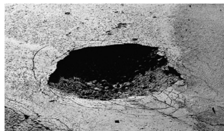
7 I buchi sul manto stradale aumentano le vibrazioni.
