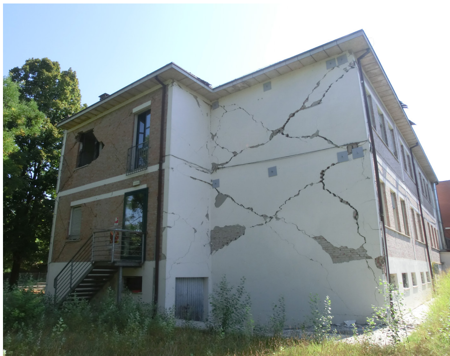
FIGURA 1 – Le misure di protezione in caso di sisma hanno valore limitato in caso di danni strutturali gravi, ma possono invece evitare o limitare i feriti nel caso di piccoli crolli o cadute di oggetti. Qui esempi di danni da sisma a scuole nella zona di Novi, nel modenese
