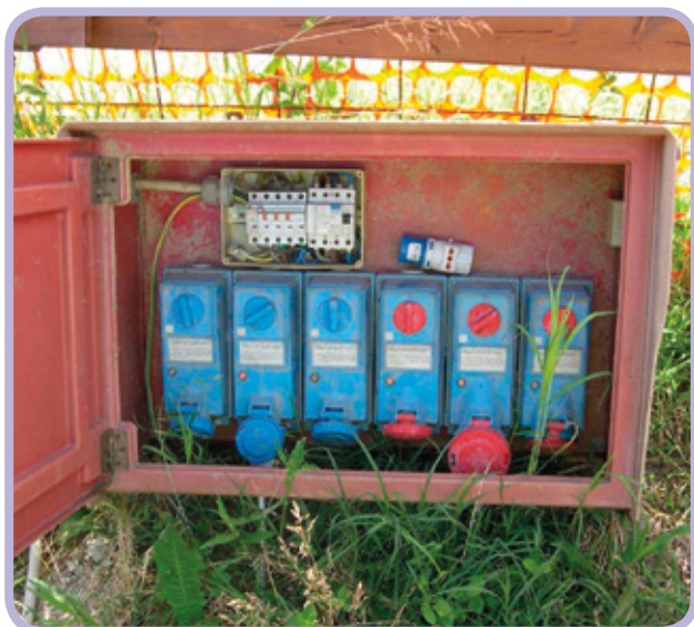
Figura 52: Coperchio mancante, parti in tensione accessibili.
