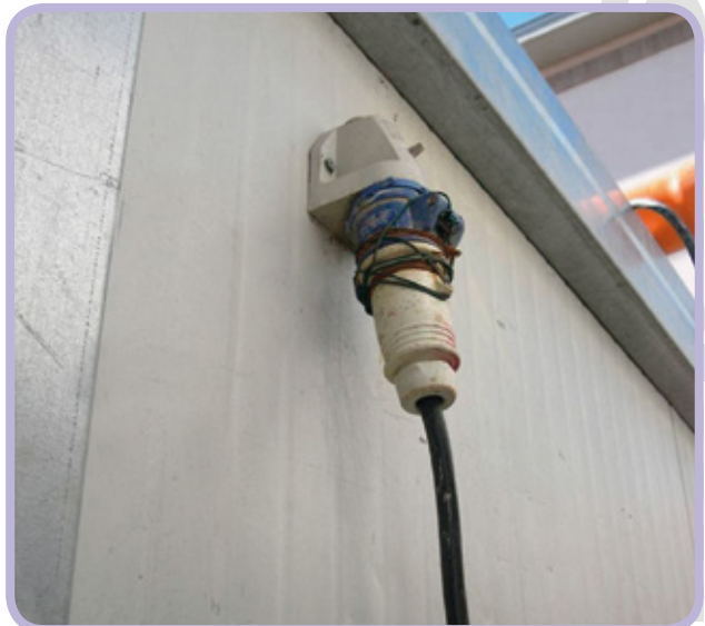
Figura 57: Coperchio presa a spina mancante, giunzione precaria.
