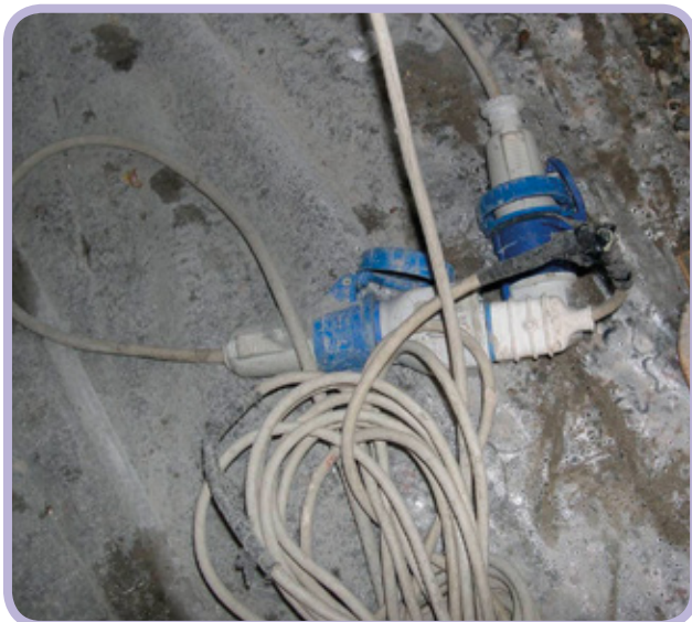
Figura 50: Cavo non idoneo per posa mobile, con guaina rotta. Presa a spina di tipo domestico non idonea, poggiata a terra.
