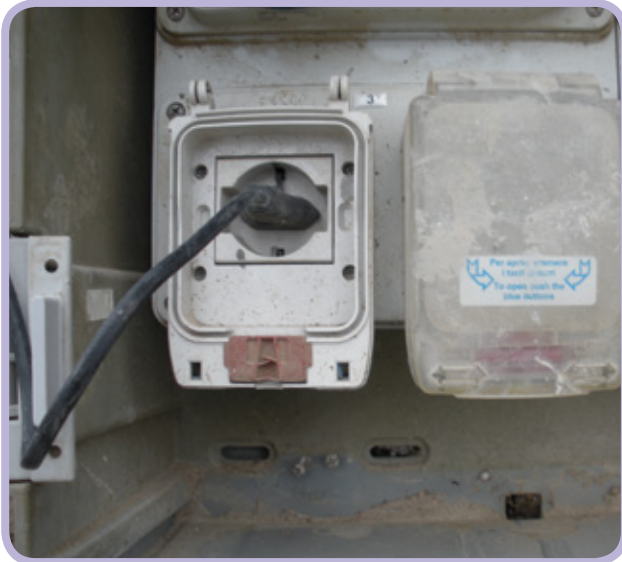
Figura 54: Coperchio presa quadro ASC mancante.
