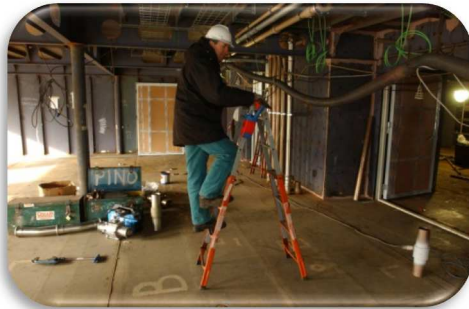
Lavori su o con scale
