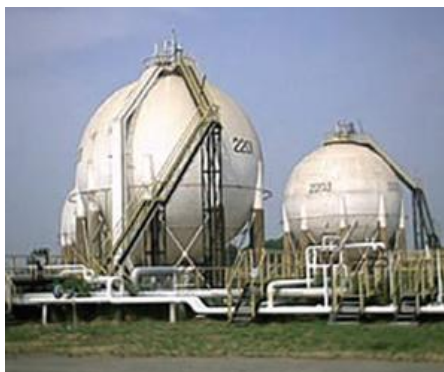
Fig. 5. – Serbatoi di GPL
