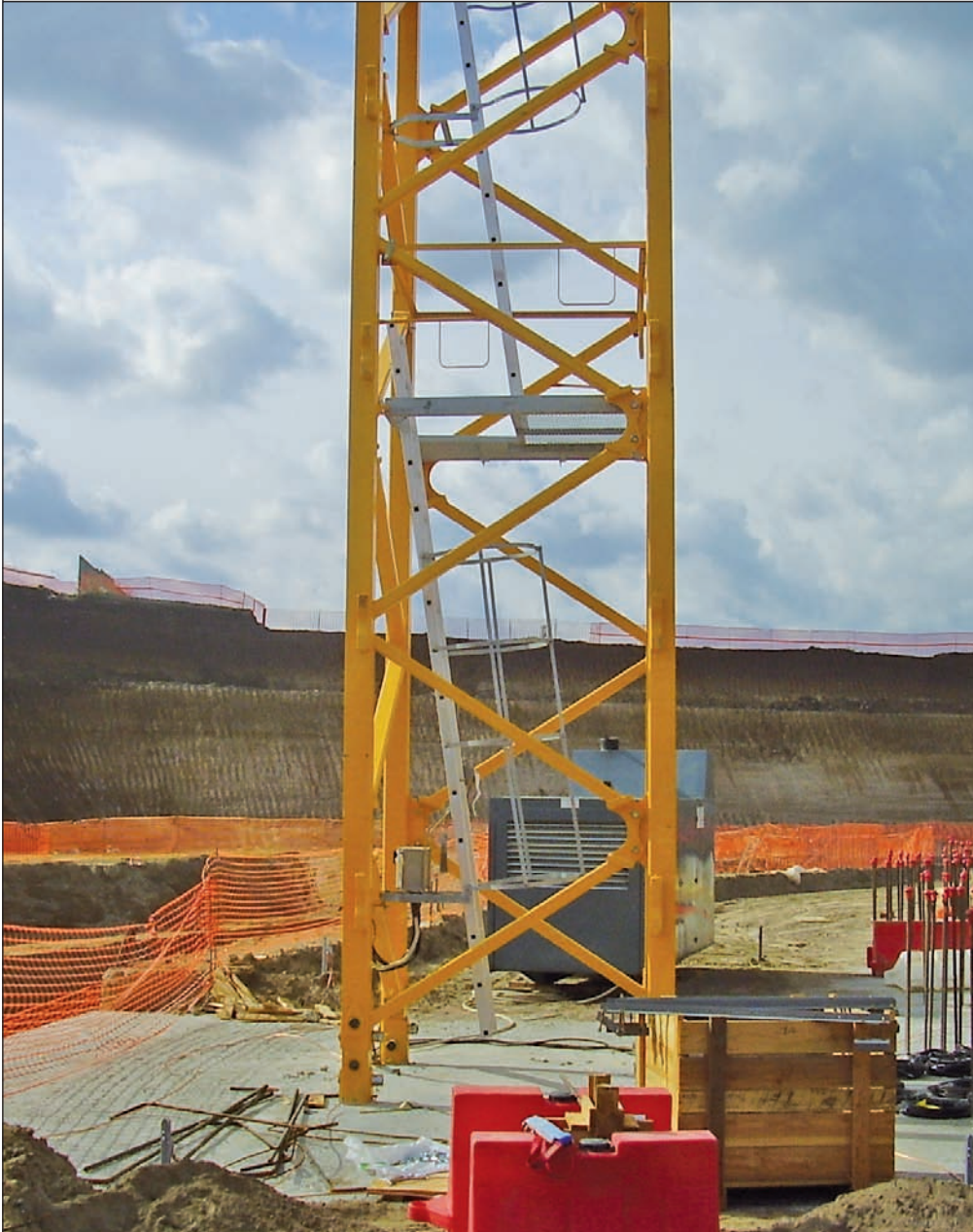
Gru di ultima generazione. Scala verticale inclinata con pianerottolo di stazionamento e servizio
