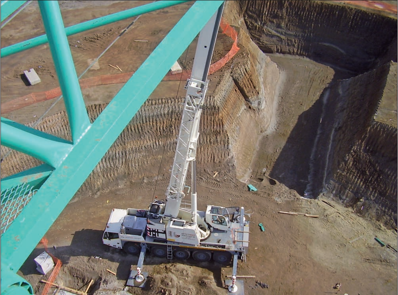
Sviluppo in quota del braccio dell'autogru a servizio del montaggio della gru a torre
