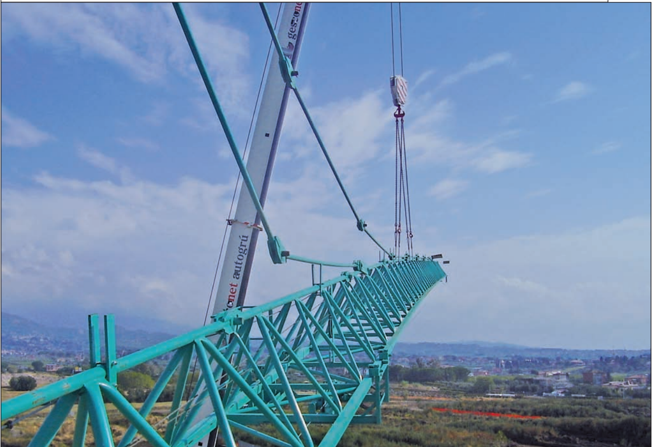
Il braccio, ormai montato, è ancora sostenuto dall'autogrù. Il sistema di aggancio è visibile sullo sfondo
