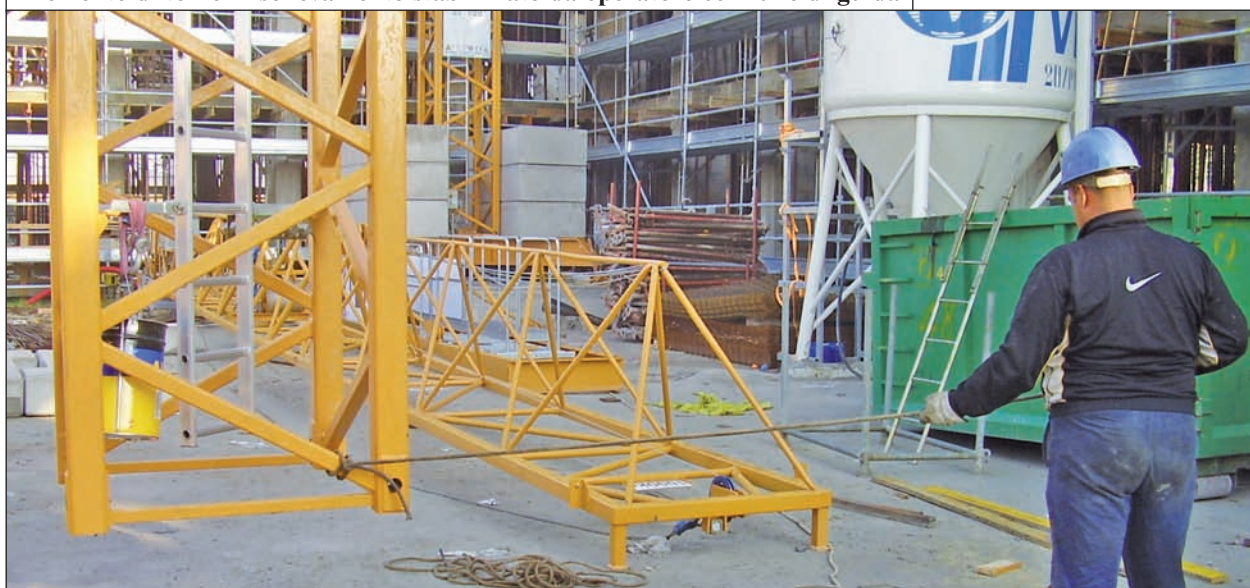
Elemento di torre in sollevamento stabilizzato da operatore con fune di guida
