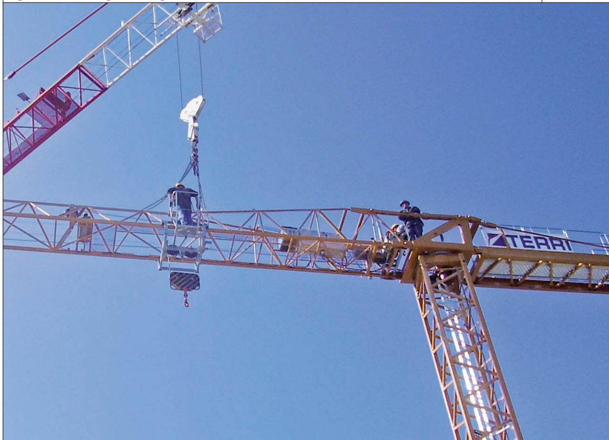
Sgancio delle braghe dall'operatore a bordo del ballatoio installato sul carrello di sollevamento
