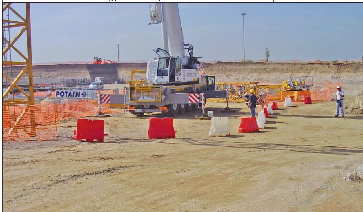
Delimitazione dell'area di montaggio con rete di plastica e barriere ad alta visibilità
