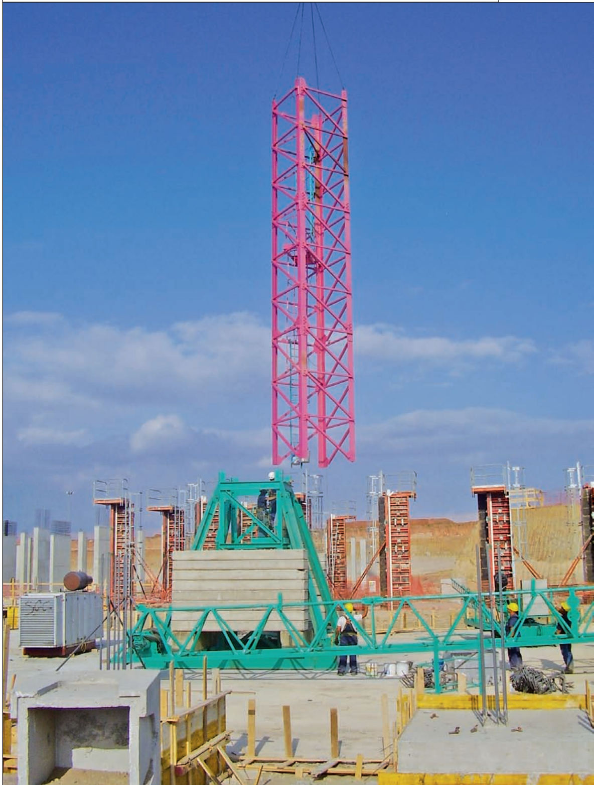
Sollevamento e trasporto in quota dell'elemento in prossimità di quello già montato
