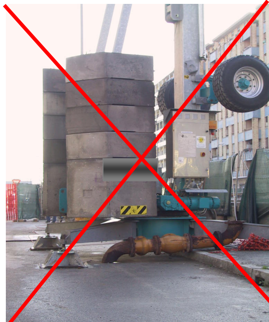
NO E RISCHIO DI DEPOSITO MATERIALE
