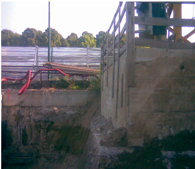
ALLA BASE DI UNA GRU NON SI SCAVA
