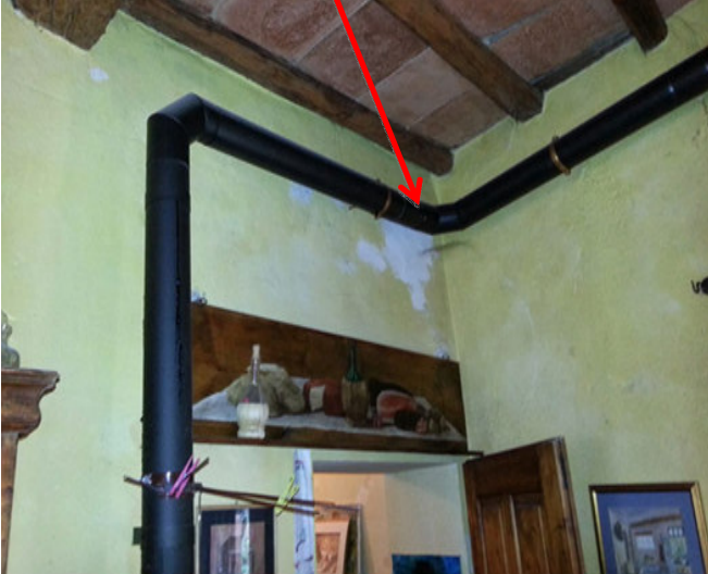
Elementi orizzontali e troppe curve
