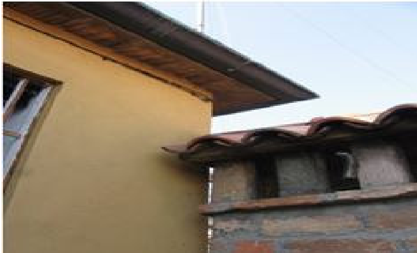
Fig. 3 - Caso di intossicazione da monossido di carbonio – comignolo di una caldaia di tipo B
