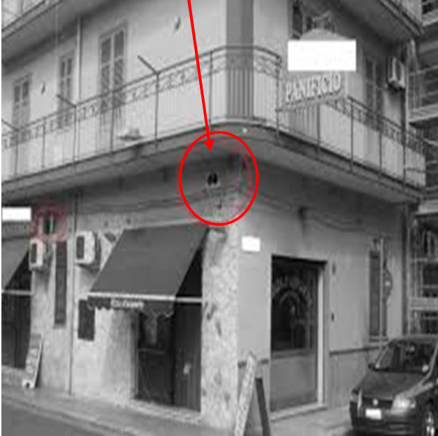
Assenza del terminale di scarico
